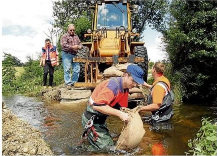
Mit Sandsäcken wurde der Überlaufsee von der Würm am Grubmühlerfeld abgetrennt. RUTT
