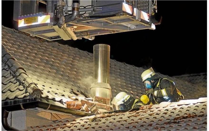
Anstrengende Arbeit: Feuerwehrleute mit Atemschutzgeräten mussten Teile des Dachs abdecken.
